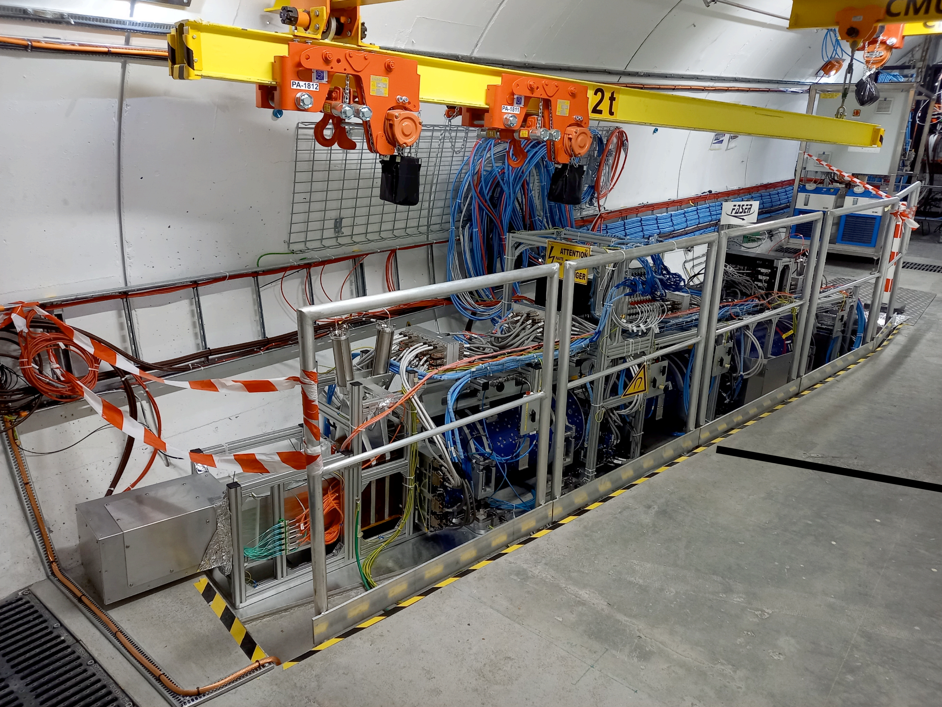
Actual FASER detector in actual tunnel.
